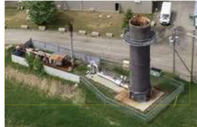
Combustion grâce à une torchère (CO 2 = 20 à 25 fois moins polluant que le méthane)
